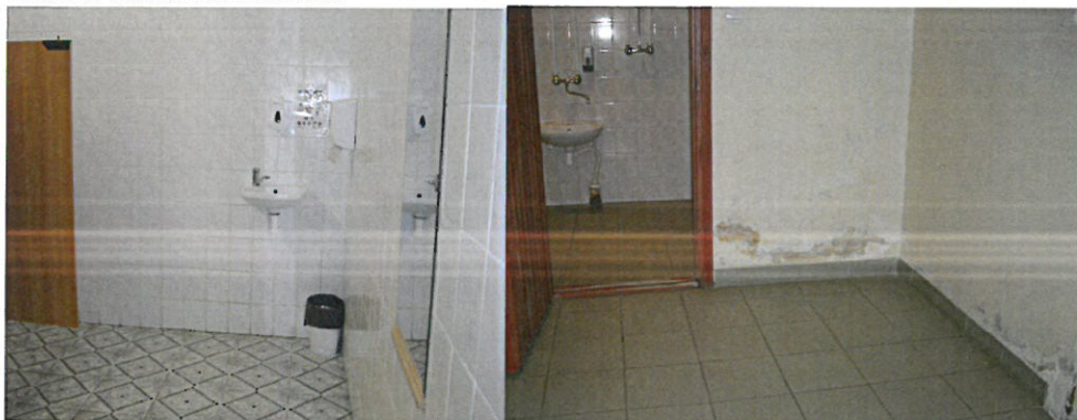
Keldrikorrusel asuvad garderoobid. Puudub nõuetele vastav ventilatsioon, kütte, valgustus.
